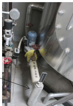
写真 2.6 給湯 2 次側還り
