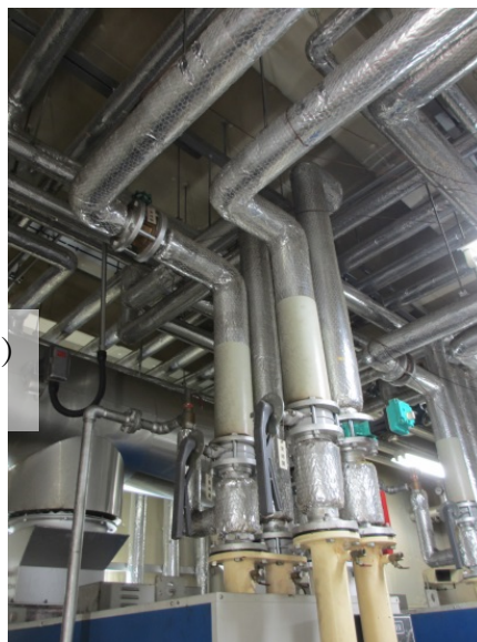
写真 2.16 ボイラーまわり
