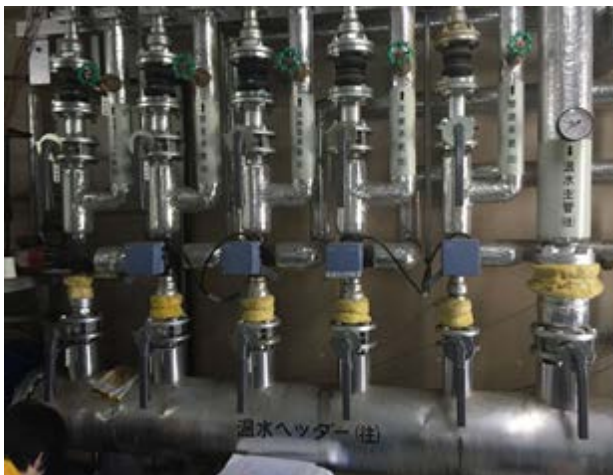
写真 2.8 ヘッダーから各系統に温水が送られる暖房系統)
