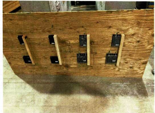
写真 4-9 コンセント裏側
